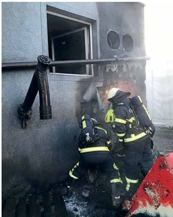
Požar kotlovnice javnega centralnega ogrevanja v Kuzmi (junij 2019)
